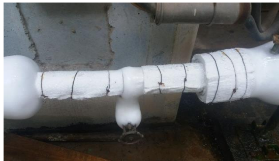
شکل ۴- عدم تشکیل کندانس و یخ در بخش‌های عایق شده با بلنکت آبروژل در دمای سیال منفی ۴۰ درجه سلسیوس (قسمت‌های یخ زده بدون عایق بوده و دو ماه زمان داده شده است، پتروشیمی جم)
