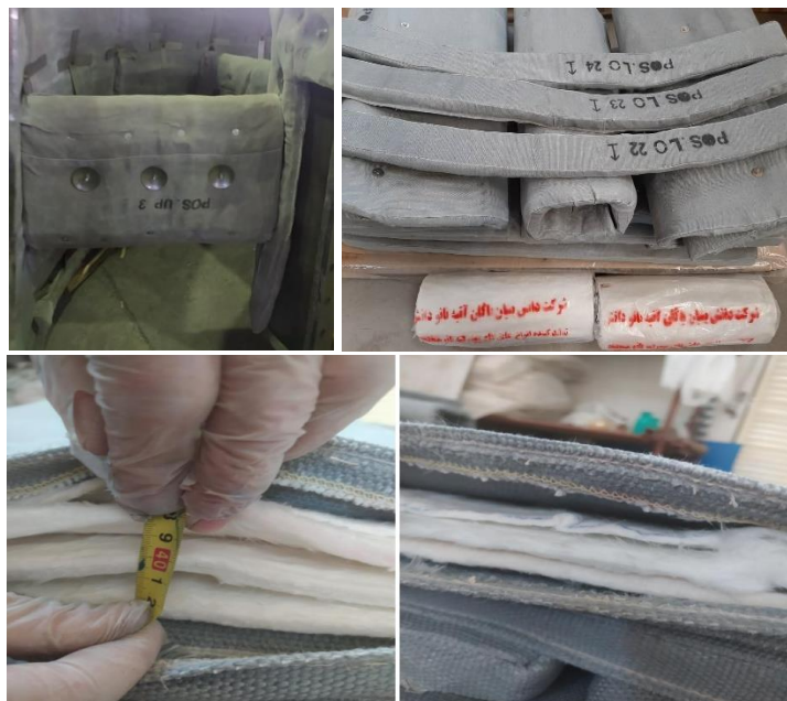
شکل ۱۹- عایق‌های ژاکتی حاوی بلنکت آبروژل نصب شده روی لاینر اگزاست توربین گازی (تولید شرکت پاکان آتیه ناندانش)
